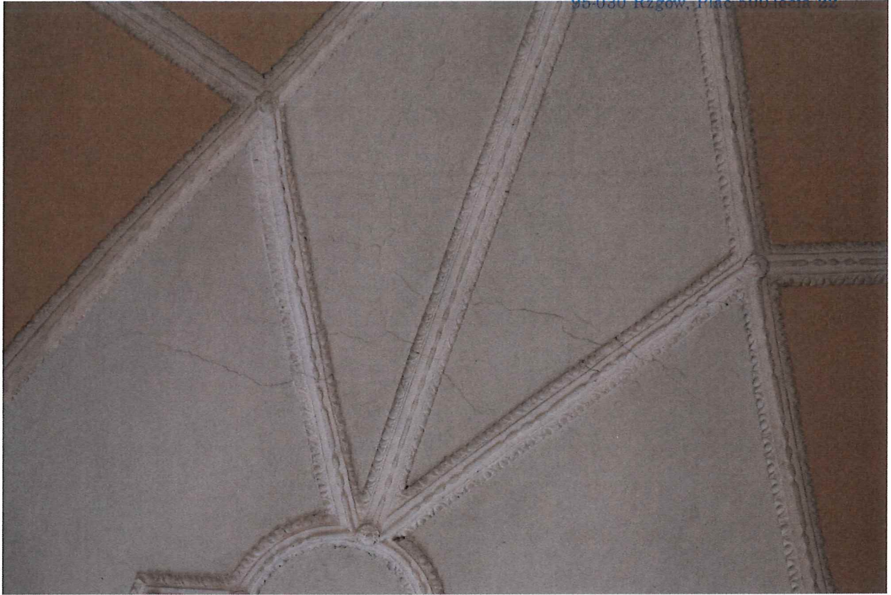
Fot. 8. Spękania tynków i sztukaterii na sklepieniu.
