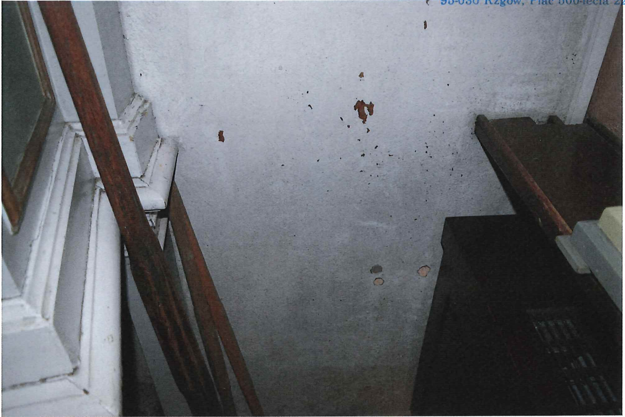
Fot. 17. Złuszczenia wtórnych farb na marmoryzacjach.
