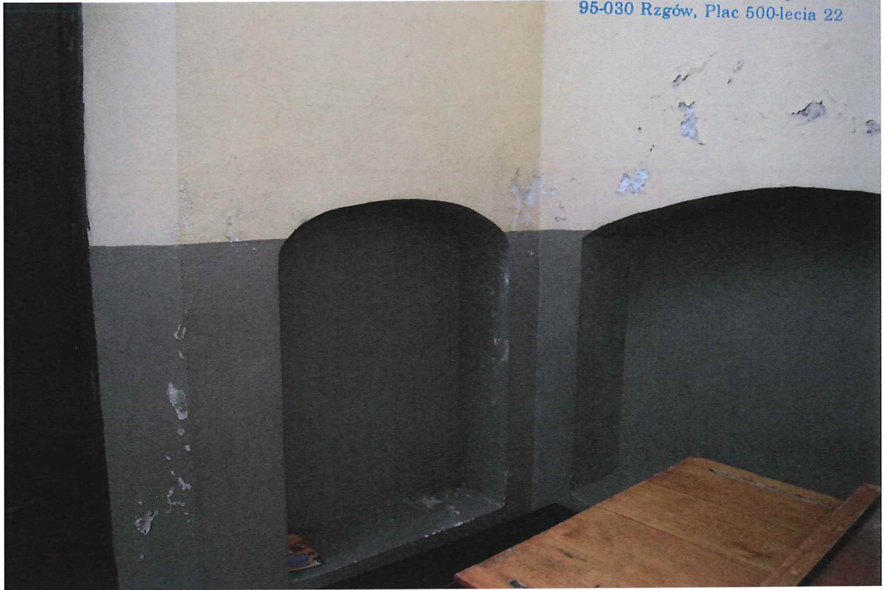
Fot. 22. Kruchta południowa - zawilgocenia i zasolenia ścian.
