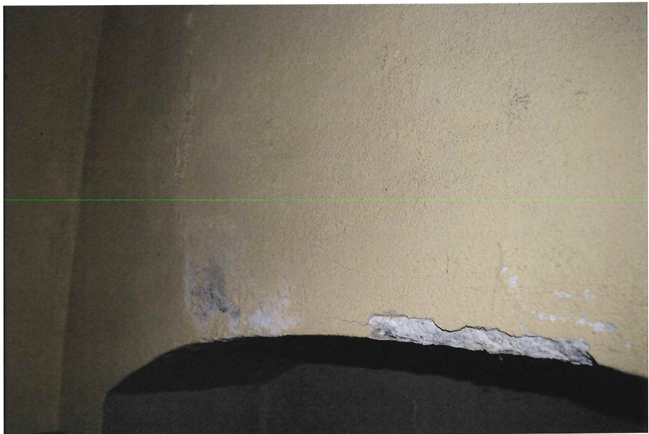
Fot. 23. Kruchta południowa - zawilgocenia i zasolenia ścian.
