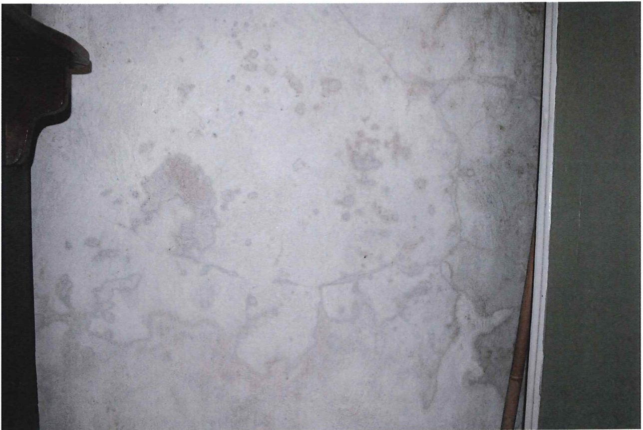
Fot. 14. Zawilgocenie ściany północnej w przyziemiu.
