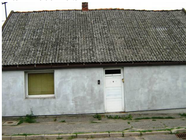
Rys. 7. Pokrycie dachowe ocenione w II stopniu pilności.
