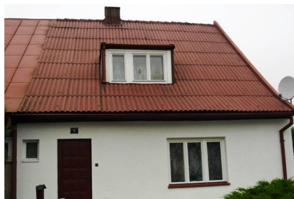
Rys. 6. Pokrycie dachowe ocenione w III stopniu pilności.
