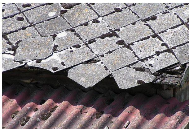
Rys. 8. Pokrycie dachowe ocenione w I stopniu pilności.
