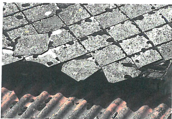
Rys. 8. Pokrycie dachowe ocenione w I stopniu pilności.
