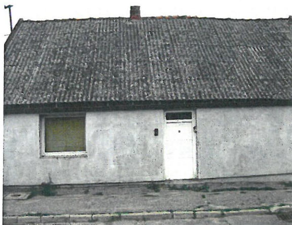
Rys. 7. Pokrycie dachowe ocenione w II stopniu pilności.
