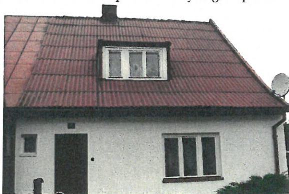
Rys. 6. Pokrycie dachowe ocenione w III stopniu pilności.
